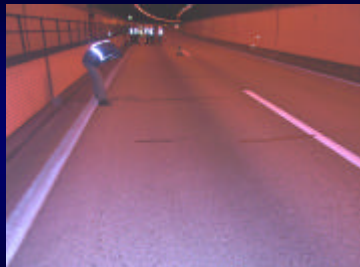
松山道 山根トンネル 平成3年1月供用 (平成13年撮影) -目地間隔30m箇所におけるクラック発生状況
