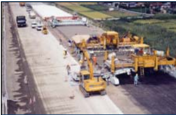
スリップフォームパーによるコンクリート舗装の施工
